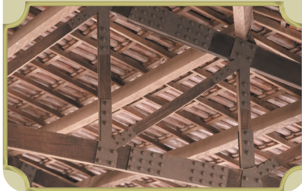
Fotos 151 - Detalhes (ainda visíveis) do que fora a cobertura da “Churrasqueira Nova da AABB Maringá”, uma das realizações da 30ª Diretoria (1989/1992).
